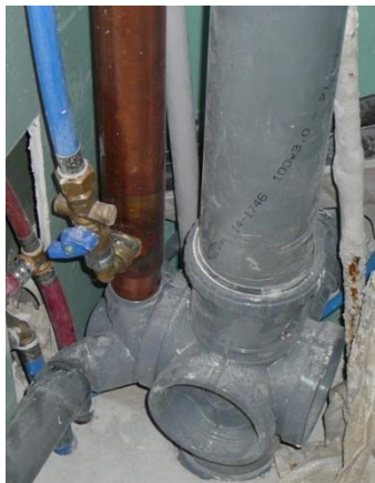
17 Lgts collectifs Montreuil (93) Installation mixte
